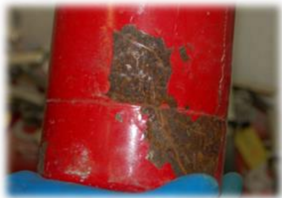
54.att. Korpusa korozijas bojājumi
